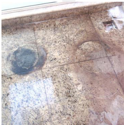
Piso corroído e manchado
