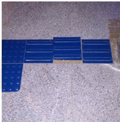
Piso tátil interno com peças soltas e faltantes
