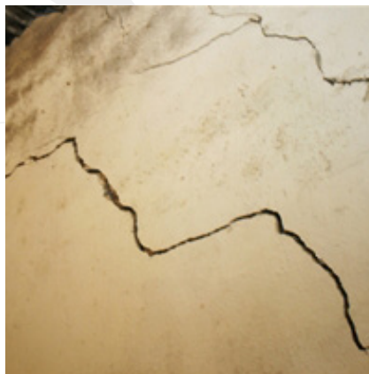
Rachaduras na alvenaria
