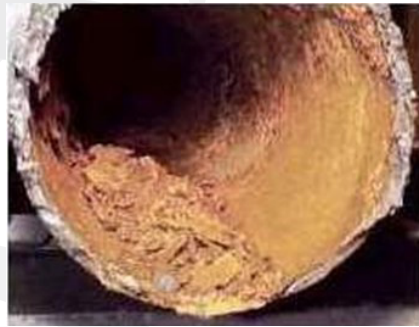
Tubulação de sprinkler corroída
