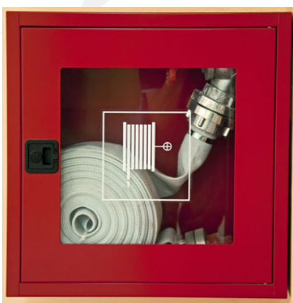
Hidrante de parede
